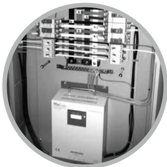
현장 설치 판넬
