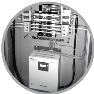
현장 설치 판넬
